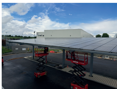
Ombrières sur parking
