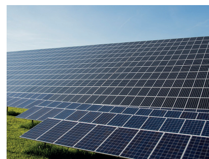
Petites centrales au sol
